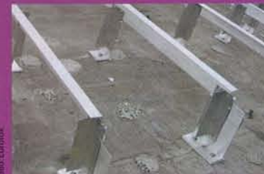
Durch die Ungenauigkeiten der alten Beton-Hülle ergaben sich unterschiedliche Vorgaben für die Unterkonstruktion. Differenzen von bis zu 16 cm mussten ausgeglichen werden.
